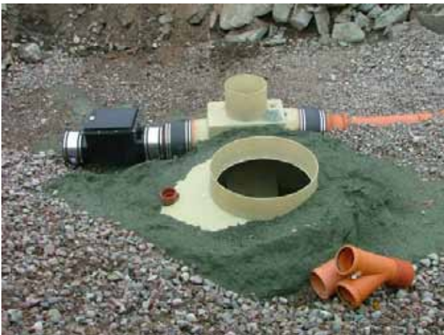
Figur 7.7: Installerad oljeavskiljare typ MIRI OAM BP21/15s försedd med larm, "bypass-funktion" och backventil
