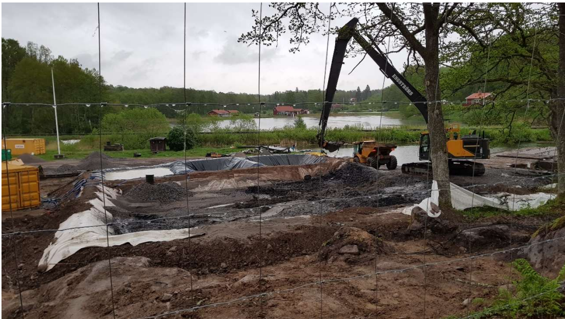
Figur 8 Avvattningsanläggning och bassänger för sedimentering av vatten. Reningsverk i container till vänster.
