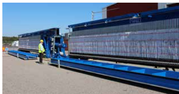
Kammarfilterpressar i väntan på installation. Varje press vägde 50 ton och sammanlagt 5 pressar installerades för avvattning av sediment. Foto: Oskarshamns kommun
