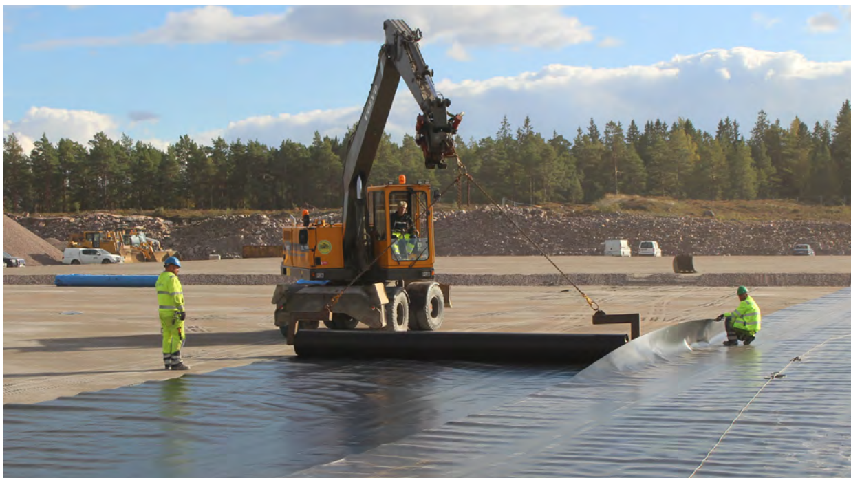
Figur 8.1 Installation av syntetiskt geomembran på Storskogens deponibotten. Foto Anna Kinch, Oskarshamns Kommun.
