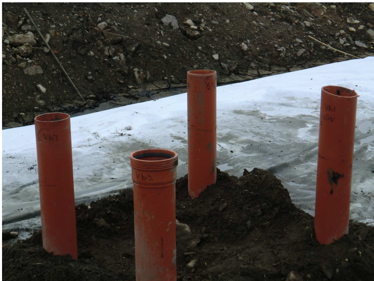
Figur 7 Skyddsror utplacerade innan överlasten lagts på plats. Rör med VB 1 och GV rör längst till höger, VB 2 närmast, VB 3 längst till vänster.
